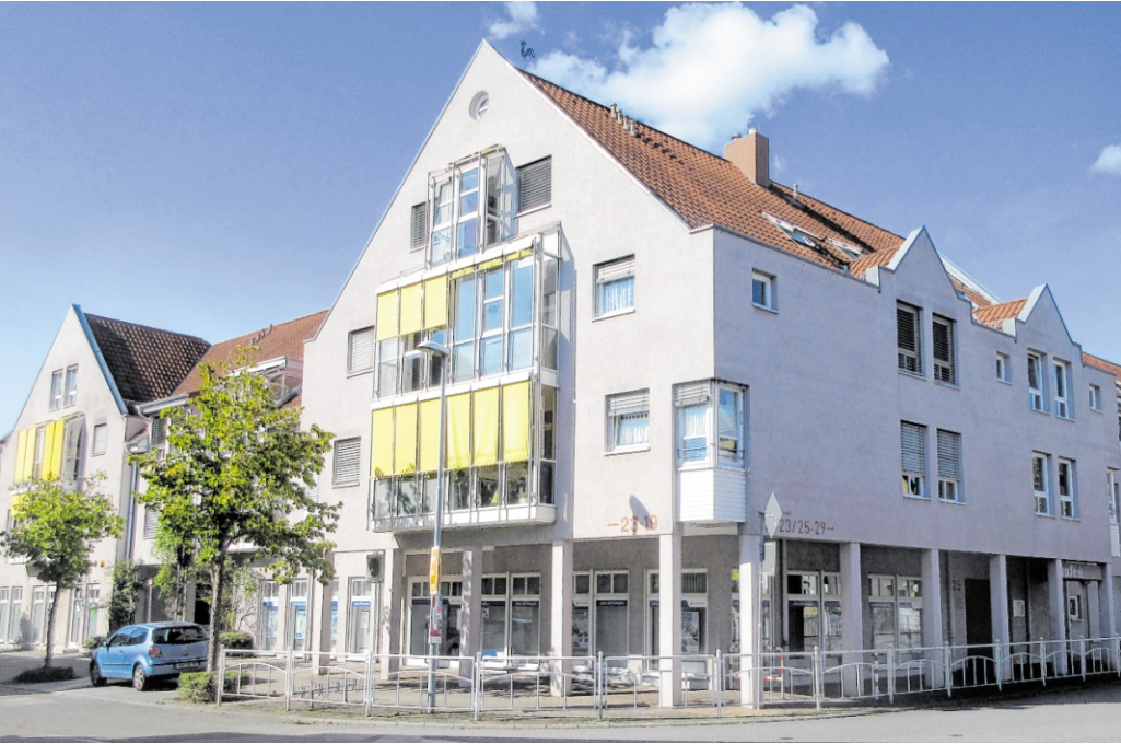
Die Anlage Siegwald-Kehder-Haus ist nach über 30 Jahren renovierungsbedürftig.
