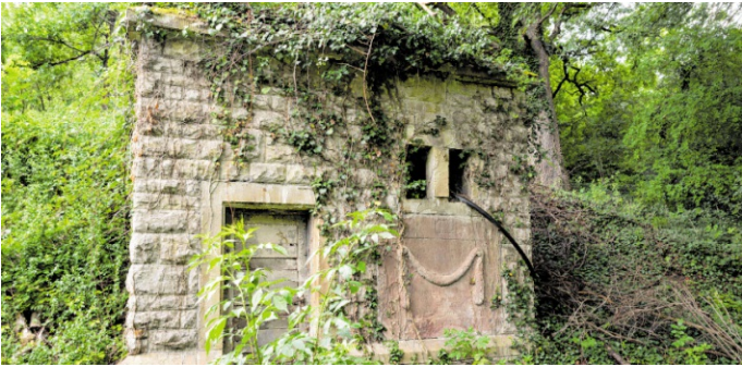
Als Zuzenhausen eine zentrale Wasserversorgung erhielt, wurden 1907-1909 zwei Quellen gefasst und in diesen Wasserhochbehälter geleitet.
