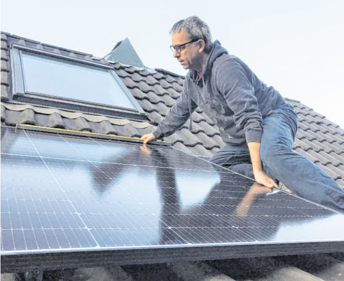
Von der Solaranlage bis zur Dämmung: Beim Austauschabend des Weinheimer Klimaschutzmanagements gibt es unabhängige Beratung, spannende Erfahrungsberichte und aktuelle Fördertipps – alles an einem Abend, kostenlos und direkt vor Ort.
