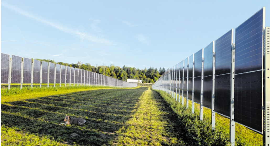
Die Agri-Photovoltaik-Anlage in Furfeld verbindet landwirtschaftliche Nutzung mit der Erzeugung von Solarstrom.
