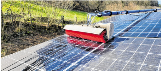
Durch äußere Umwelteinflüsse verschmutzen Solar- und Photovoltaikanlagen im Laufe der Zeit enorm, deshalb ist es wichtig, dass sie regelmäßig gereinigt werden.
